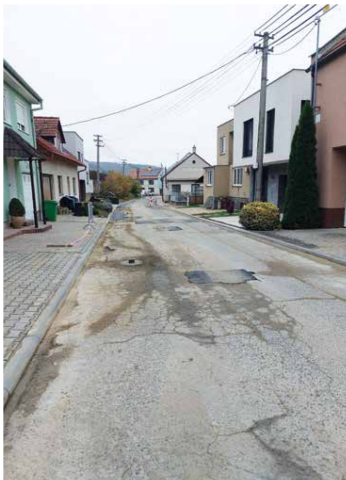
Vozovka byla v nevyhovujícím stavu
