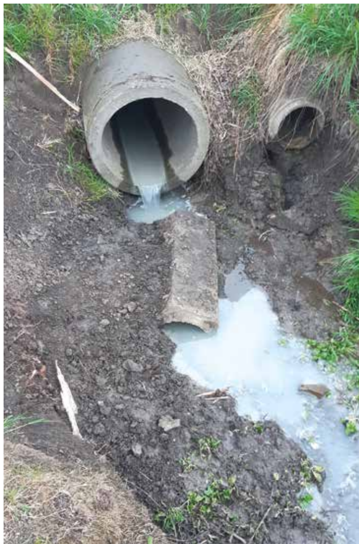
Vypouštění splašků do nádrže.
